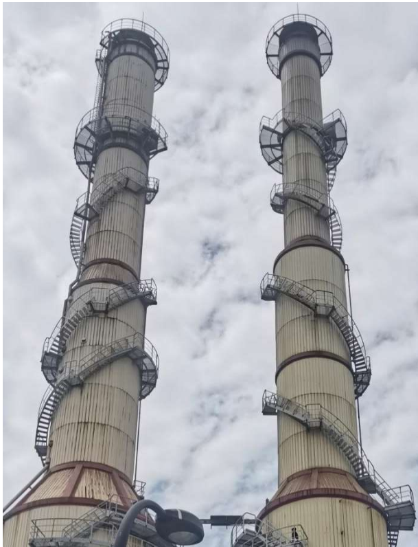
锅炉脱硫塔+烟囱（DA01、DA03）
