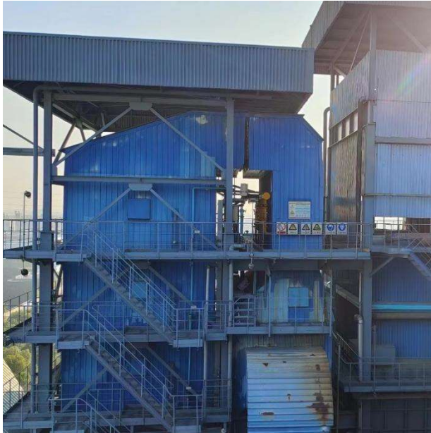
锅炉烟气脱硝系统（喷氨区）
