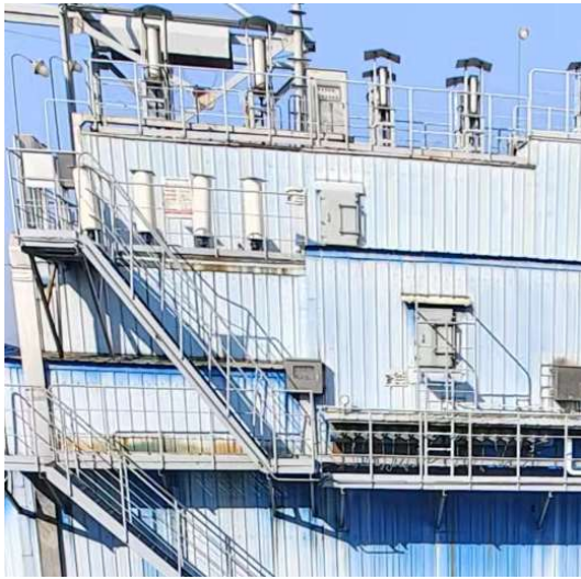
锅炉烟气布袋除尘区
