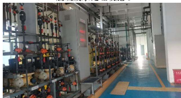
脱硫废水处理设施 2
