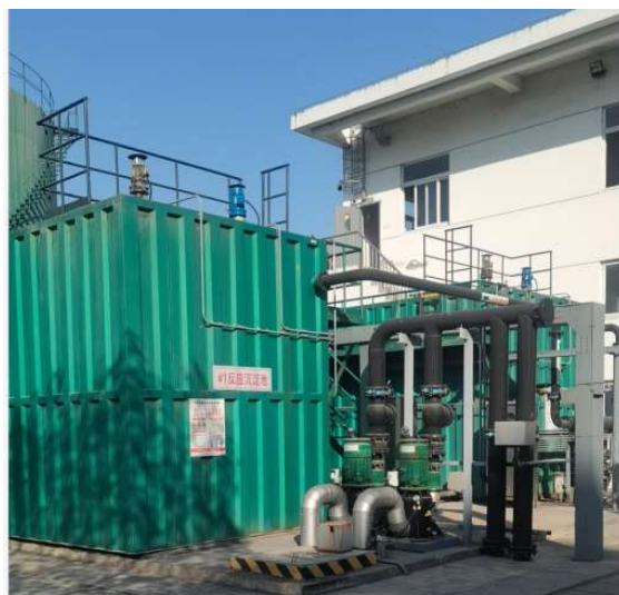
污泥处理设施
