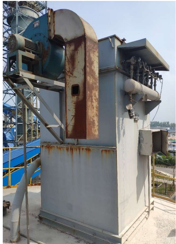
石灰石粉仓除尘器
