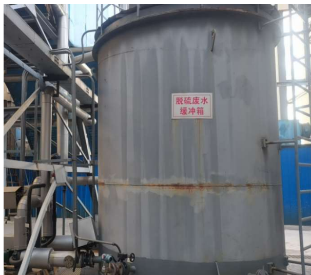
脱硫废水处理设施 1
