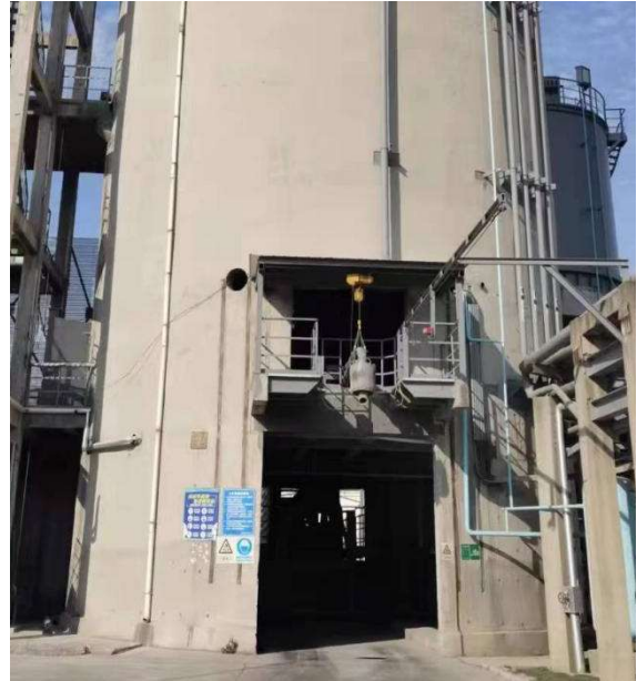
灰库布袋除尘器
