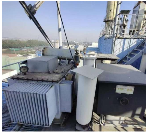
锅炉烟气电除尘区域
