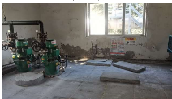
酸碱废水处理设施
