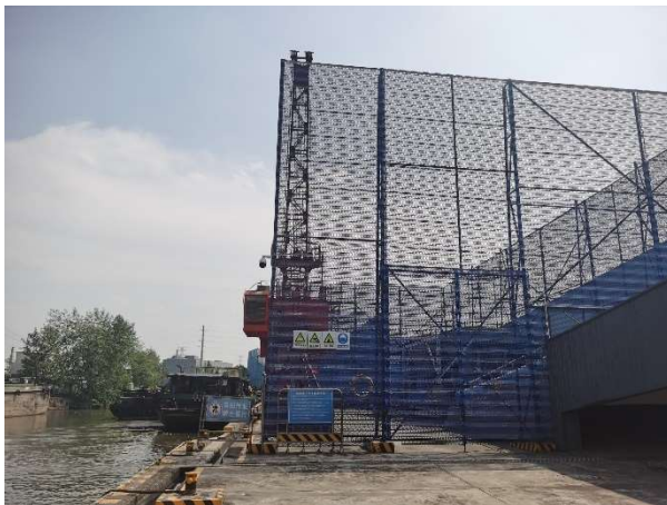
码头装卸区抑尘设施
