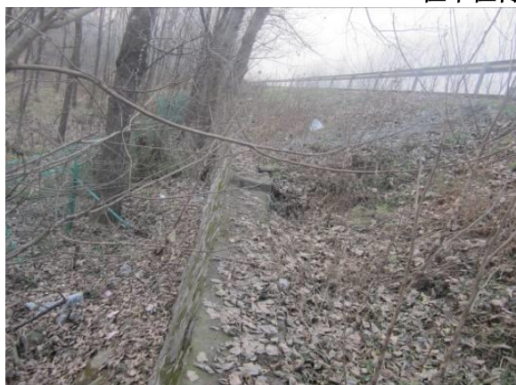
挡墙防护现状图
