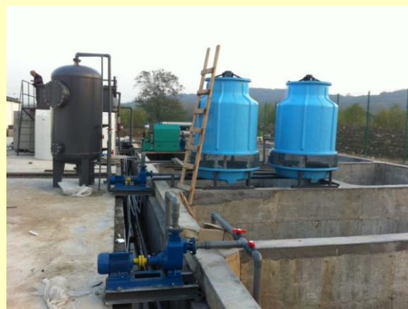
丁蜀镇洑东厂区废水处理系统 2
