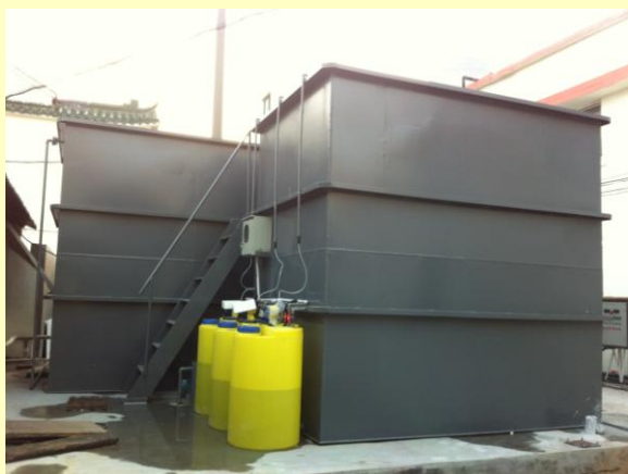
丁蜀镇洑东厂区废水处理系统 1
