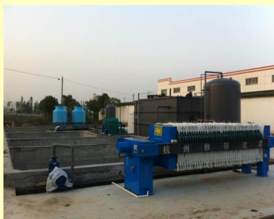
环科园厂区废水处理系统 2
