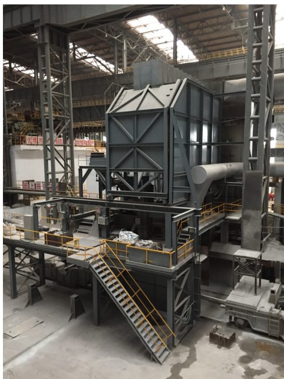
LF 炉废气收集系统
