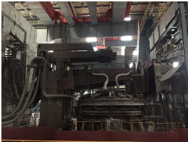
图 7.1-1 保温炉炉废气收集系统（第四孔）
