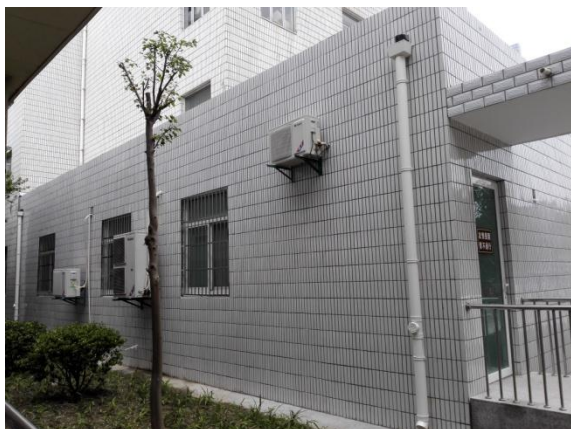
图 8-1 DSA 机房东侧
