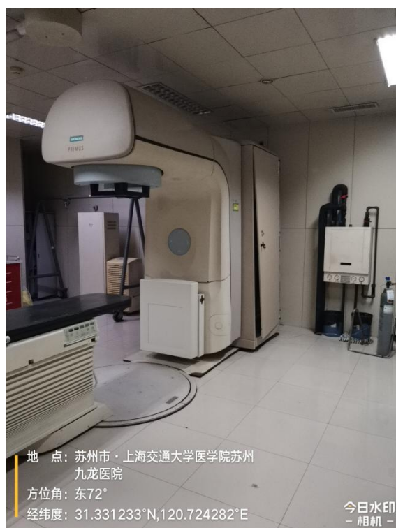
图 8-10 加速器机房（原设备未拆除）
