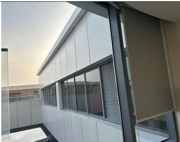
DSA 复合手术室楼上设备机房
