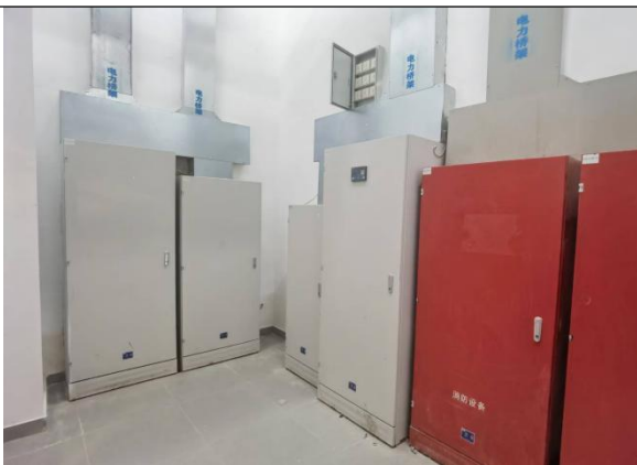
核医学科楼上配电间
