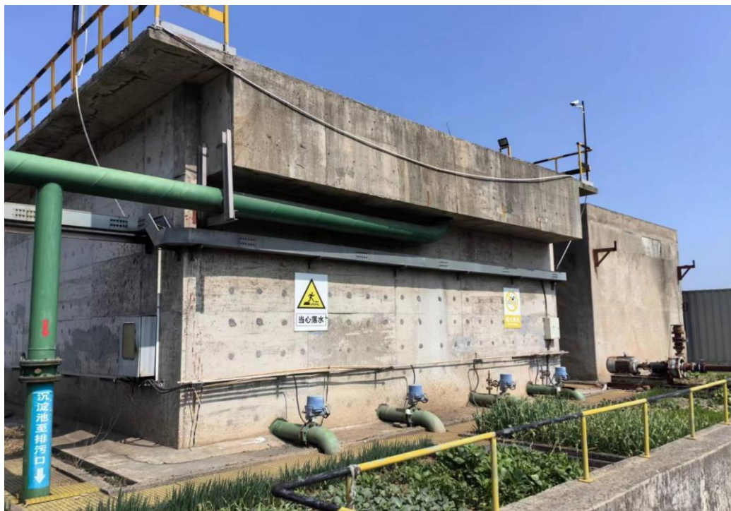
图 4.7-2 厂区内净水站现场照片
