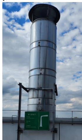
DA001 锅炉废气
