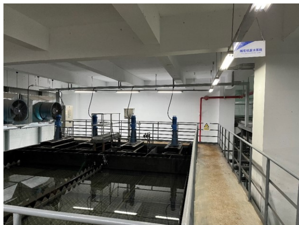
含氟废水处理系统
