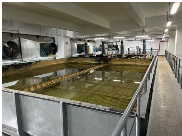
碱性有机废水处理系统
