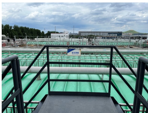
综合废水生化处理系统 A/O
