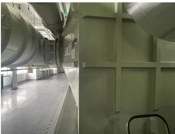
DA002 废气处理设施（氨气）
