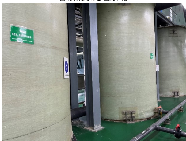
含氨废水处理系统
