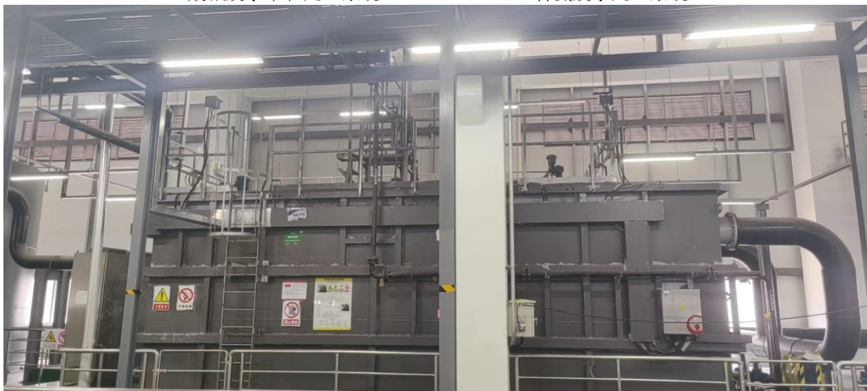
含砂废水处理系统
