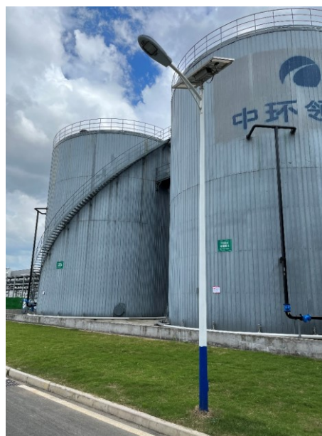
综合废水处理系统水解池
