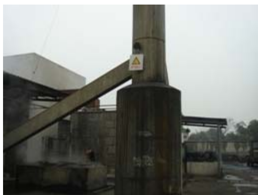
锅炉废气排气筒
