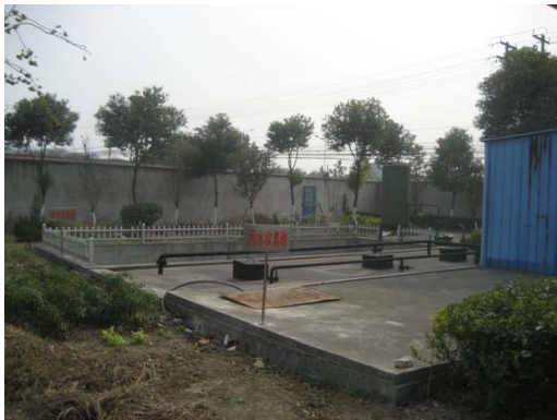
污水处理装置
