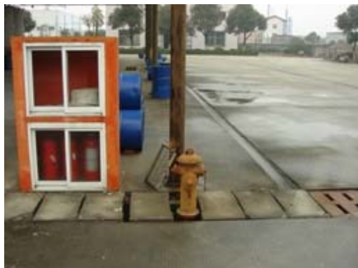
罐区消防设施
