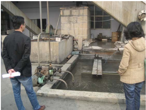
锅炉烟气除尘装置
