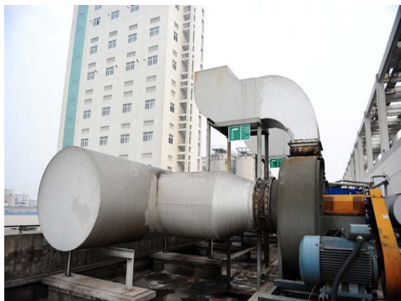
D区纺丝排气筒
