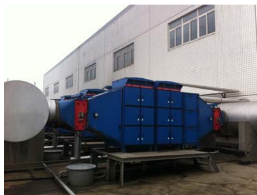
C区热煤炉脱硫脱硝装置
