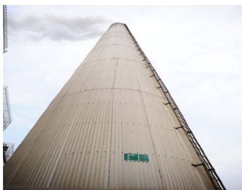
D区热媒烟囱排气筒
