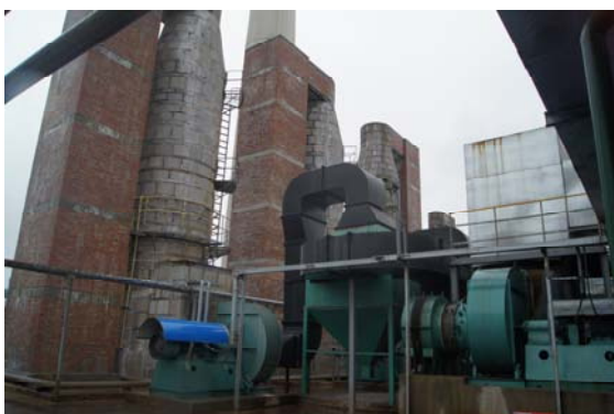
热媒炉多管水膜除尘
