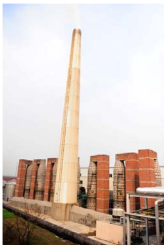
E区水膜除尘装置
