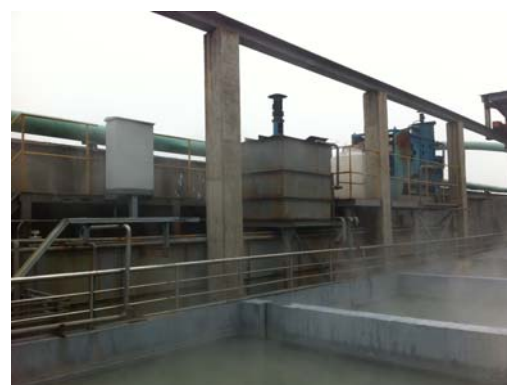
E区热煤炉脱硫脱硝装置
