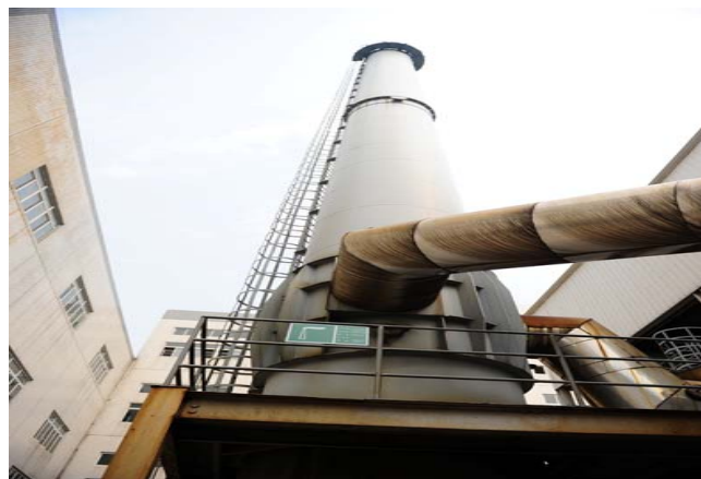
AB区燃油锅炉排气筒2
