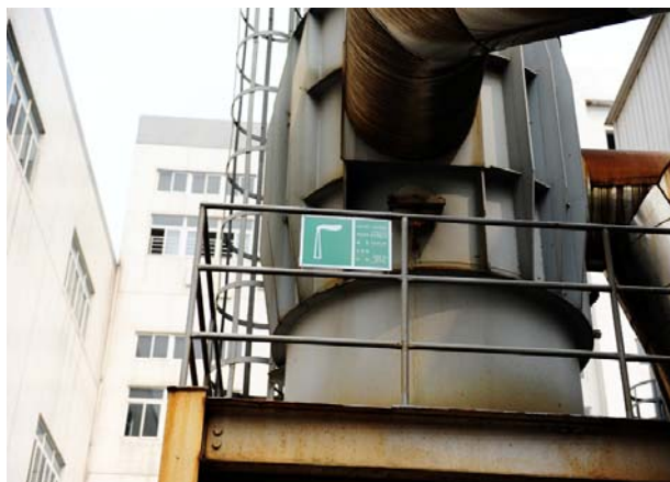
AB区燃油锅炉排气筒1
