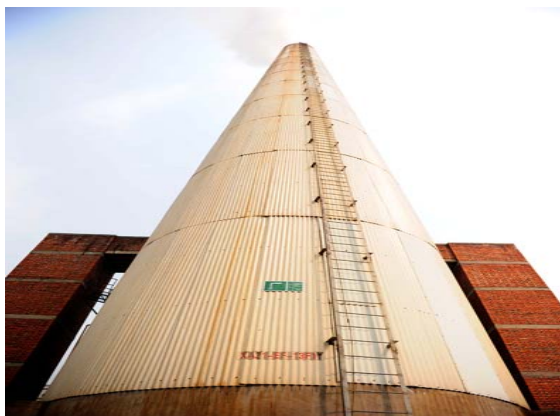
E区热媒炉排气筒
