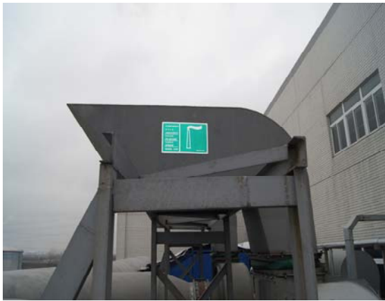
油剂废气排气筒标识
