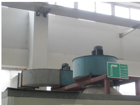
2#车间喷胶废气排放口 2
