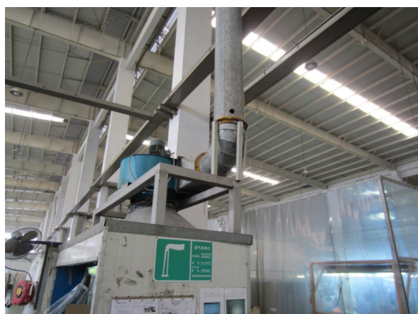
2#车间喷胶废气排放口 1
