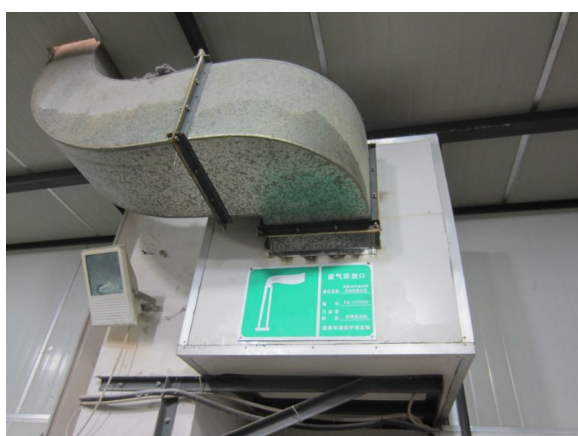
发泡工段引风机 1#及排放口
