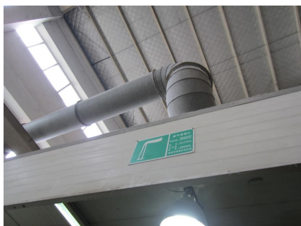
发泡工段引风机 3#及排放口
