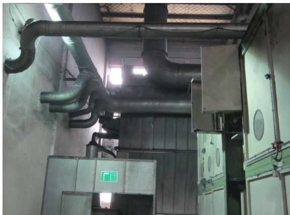
毛毡工段天然气排放口
