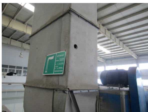
发泡工段引风机 2#及排放口
