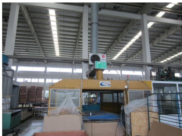
3#车间喷胶废气排放口
