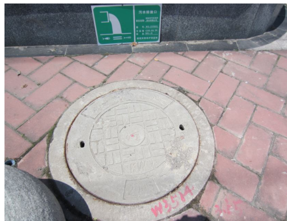
生活污水接管排放口
