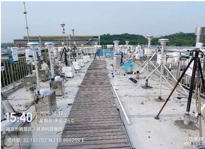
图 A.1 室外比对实验现场
