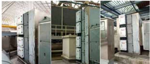
整改后的二级集中排放区
