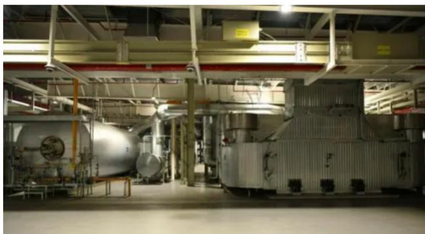
图 5.3-7 喷漆废气末端处理装置
