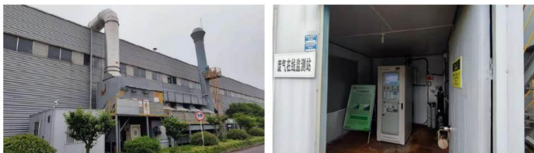
图 5.3-3 废气治理设备及废气在线监测站
