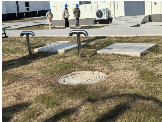
电抗器事故油池
