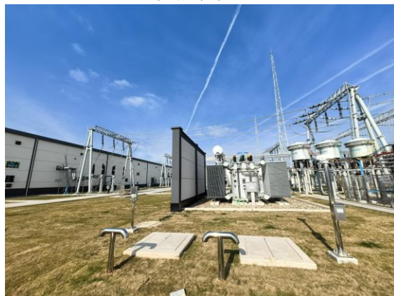
站用变事故油池
