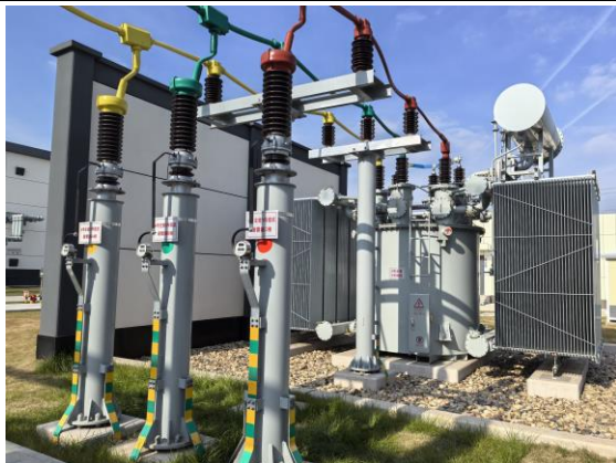
电抗器防火墙
