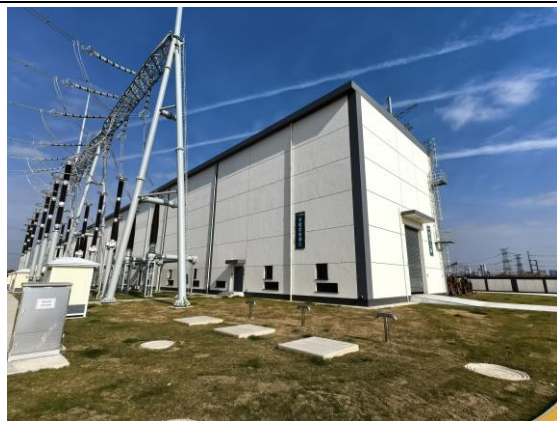
500kV 户内 GIS 室
