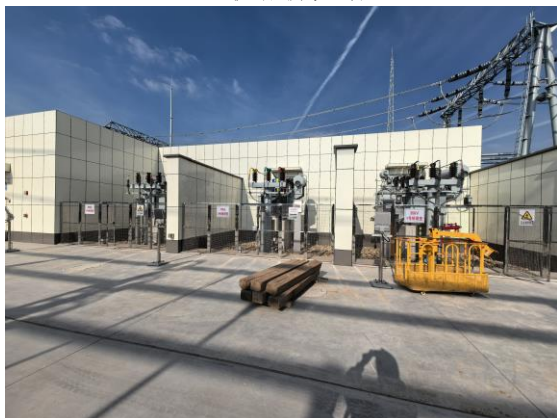
站用变防火墙
